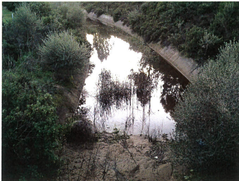
Foto n° 35: Alveo Tronco Critico ZI_B3.1.2, vista dell'accumulo di materiale in alveo nei pressi della sezione 25
