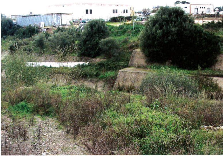
Foto n° 24: Alveo Tronco Critico ZI_B3, vista del salto di fondo in corrispondenza della sezione 17
