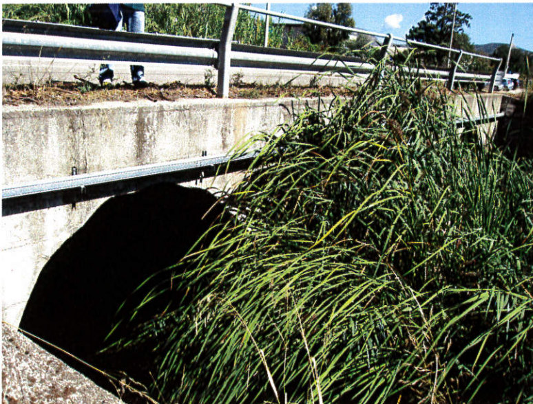
Foto n° 7: Alveo Tronco Critico ZI_B1, particolare attraversamento in corrispondenza della sez. 16 (vista da valle)
